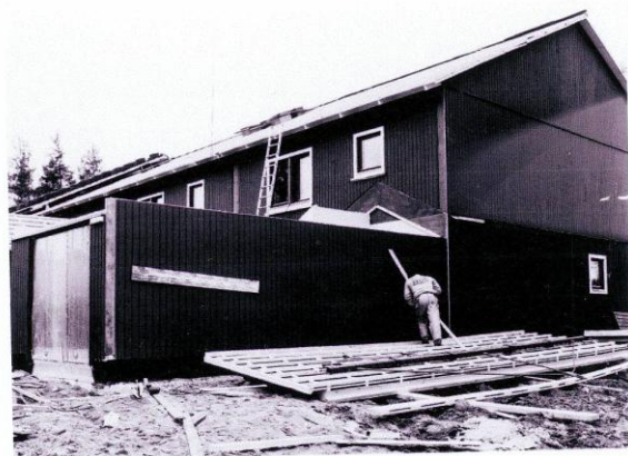
Nu är garageporten och ytterväggen mot gaveln på plats. I förgrunden ligger garagetaket.
